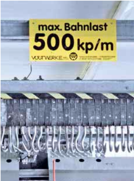
Kennzeichnung der Rohrbahn/ Marked tubular tracks
