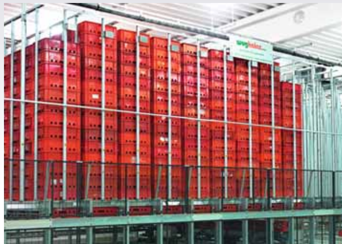
Der Leerkistenpuffer bei Abattoire liegt nun einen Stock höher/ The empty crate buffer of Abattoire where installed on the floor above the production area.
