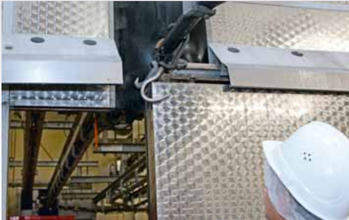
Gefahr durch einen steckengebliebenen Haken im Durchgang./ Danger of jammed hooks in the corridor.
