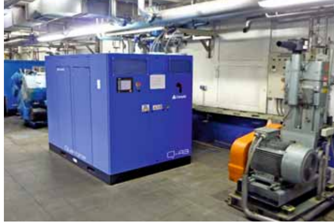
Druckluftstation mit vier ölfrei arbeitenden CompAir-Kolbenkompressoren und dem neuen Quantima™-Kompressor für die kostensparende Erzeugung ölfreier Druckluft. / Compressed air station with four oil-free working CompAir reciprocating compressors and the new Quantima™-compressor for the cost-saving production of oil-free compressed air.
