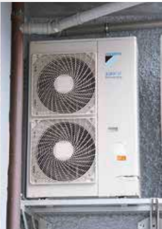
Im Verkaufsraum sowie in den Klima- und Reiferäumen kommt die Kälte aus einer Verbundanlage.
