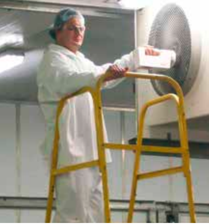
Erfassung der Keimbelastung aus/ in den Umluftkühlern. / Recording the bacterial load from/ in the recirculating coolers.
