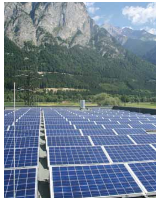
Mit einer Photovoltaik-Anlage wird umweltfreundlich Strom aus Sonnenkraft gewonnen.
