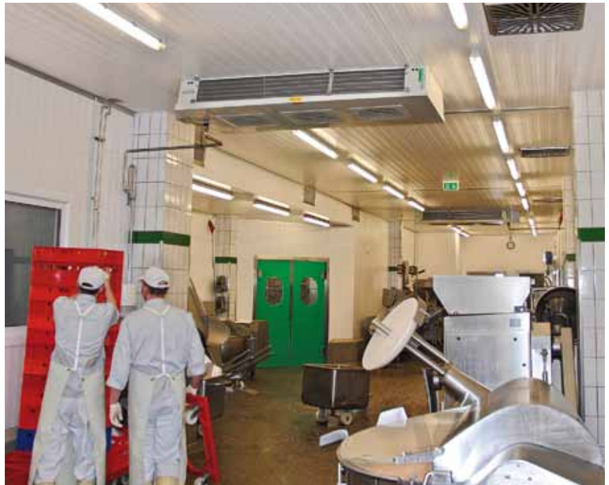
Für die Produktionsgebäude des Unternehmens Hoppe wurden zwei genau auf die vom Planer projektierten Verdampferkühler abgestimmten UV-C-Entkeimungsmodule angefertigt.
