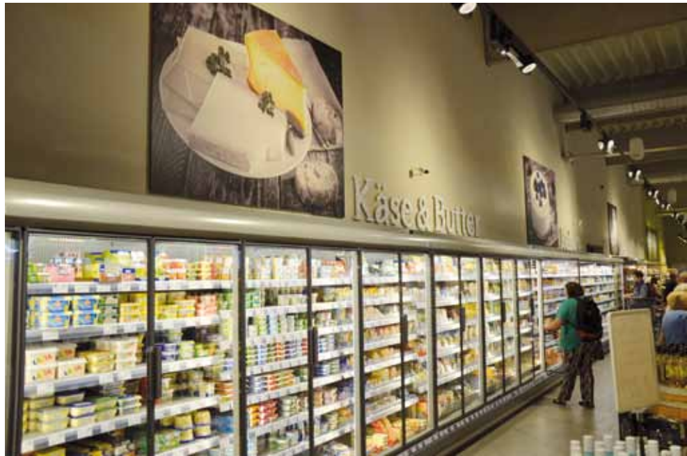
Um den Energieverbrauch im Markt so gering wie möglich zu halten und Ressourcen zu schonen, werden klimafreundliche Technologien wie eine Wärmerückgewinnungs- und CO 2 -Kälteanlage sowie LED-Beleuchtung eingesetzt.
