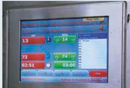
Eine Steuerung für zwei Anlagen
