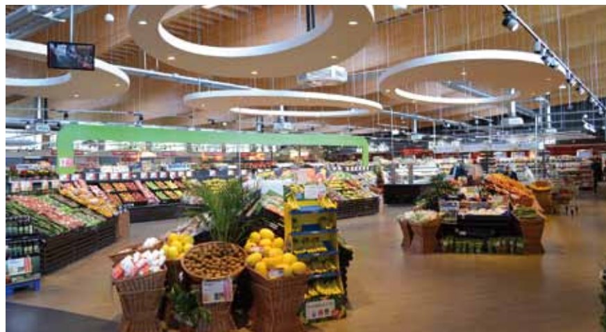
Das durchgängige und auf jede Warengruppe abgestimmte Beleuchtungskonzept mit LED setzt die Produkte in Szene und verbraucht deutlich weniger Energie als herkömmliche Lampen.
