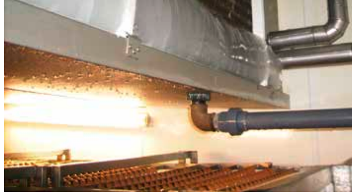
Vereisung am Kühlregister als Auswirkung von Feuchteverschleppungen. / Icing-up of the cooling coil as an effect of moisture carry over.
