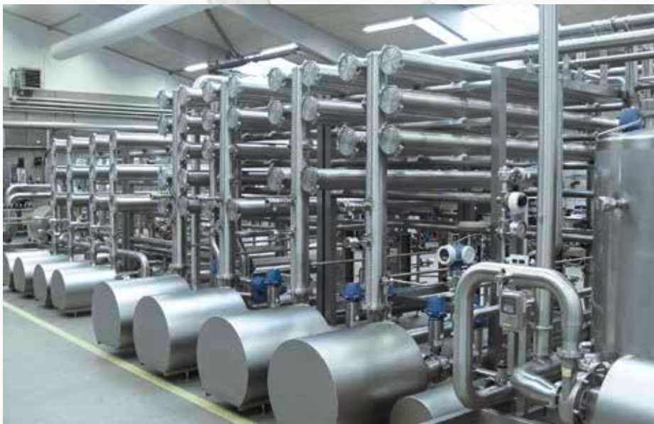
Установка обратного осмоса от GEA Filtration.
