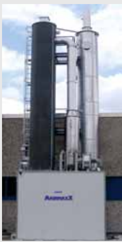
Industrieanlage mit 3.000 m 3 /h Abluftkapazität im Container zur Außenaufstellung. Auf dem Containerdach befinden sich Elektrofilter, Wärmetauscher und Wäscher.
