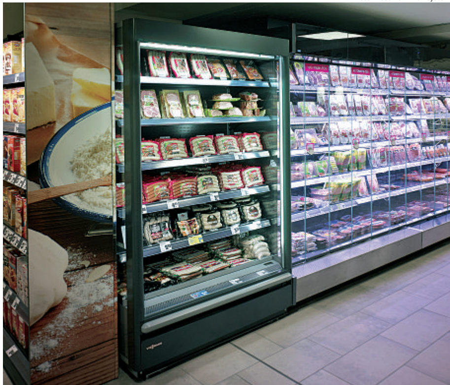
Fleisch- und Wurstwaren werden in Leho-Kühlschränken angeboten. Eine Besonderheit sind die Smart-Access-Türen, die sich berührungslos öffnen lassen.
