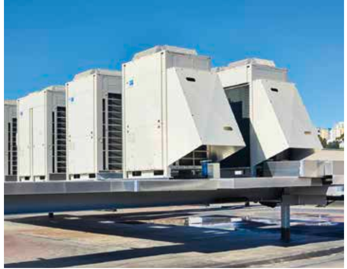
28 Zeas-Systeme auf dem Dach sichern eine geschlossene Kühlkette./ 28 Zeas systems on the roof guarantee an unbroken cool chain.
