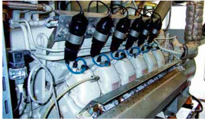
Im Containermodul des Blockheizkraftwerks: die linke Motorreihe des V12-Motors mit Abgastrakt und Turbolader./ Inside the container module of the CHP unit: one of V12 engines row, including their exhaust-gas systems and turbochargers, on the left.
