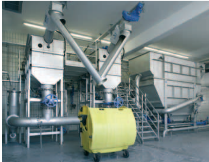
Zwei Rotoamat Siebanlagen Ro 2 neben der Huber Flotationsanlage./ Two Rotamat Drum Fine Screens Ro 2 and a Huber floatate unit.
