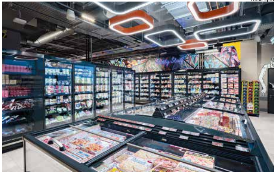
Blick in den außergewöhnlichen Supermarkt von Sandra Treugut, in dem insgesamt 60 Meter Kühlmöbel des Kältetechnikspezialisten Epta zum Einsatz kommen.
