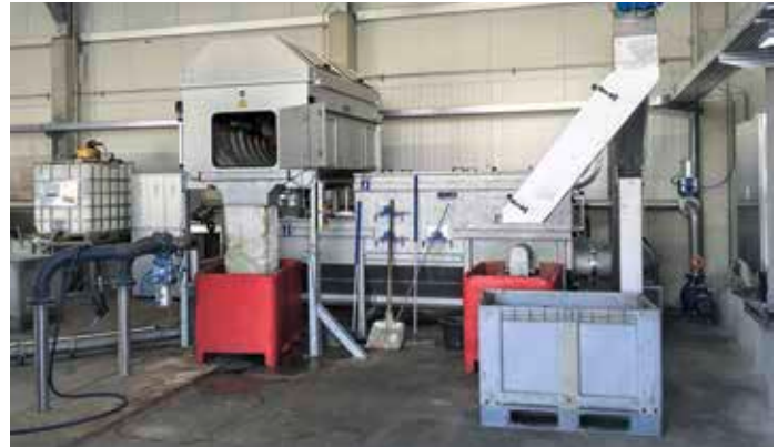
Die Huber-Experten installierten ein Trommelsieb RoMesh 3 und einen Langsandfang Rotamat Ro6 30. / The Huber experts installed a RoMesh 3 drum screen and a Rotamat Ro6 30 long grit trap.
