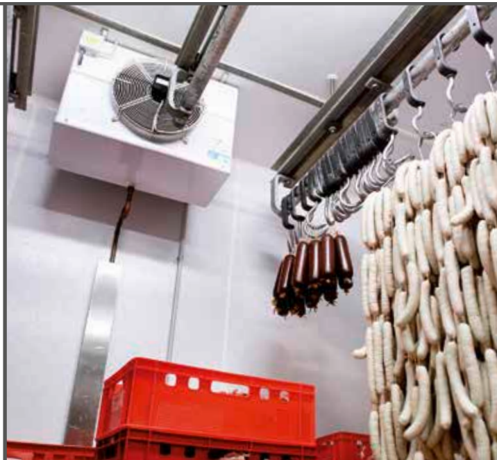
Hygienische Wände im Kühlraum
