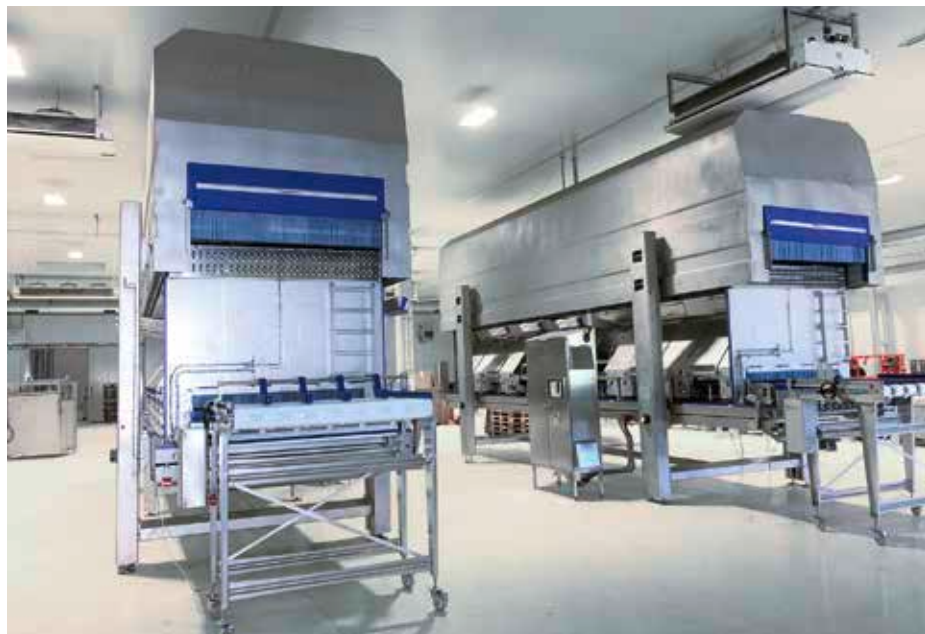
Pro Stunde können bei Steirerfleisch in den beiden Tunnelfroster von Dantech Freezing Systems bis zu 5.000 kg Schweinebauch verarbeitet werden. /
