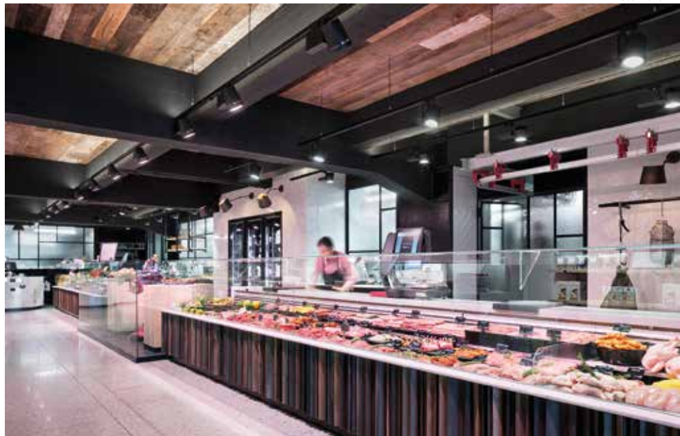
An modernen Bedienungstheken ist eine Beleuchtung Standard, die gezielt und individuell auf die jeweilige Warenkategorie abgestimmt ist.
