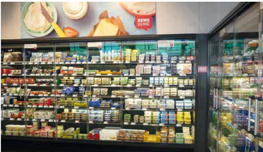
Auf Energieeffizienz wurde beim Bau des nach dem „Green-Building-Konzept“ konstruierten Marktes großer Wert gelegt. Das gilt insbesondere für die Kühlung der Wandregale.
