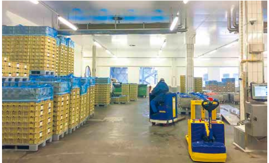
Für die Raumluftkühlung bei Micarna (Bild o. & u.) ist eine Lamellenentkeimung im Überkopfbereich im Einsatz. / For the room air cooling at Micarna (pic above & below), a lamella sterilisation in the overhead area is used.
